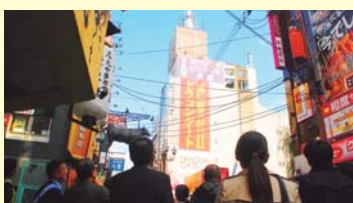
▲昨年指摘されていたが、現在改修工事が進むボウリング場の看板を見学。
